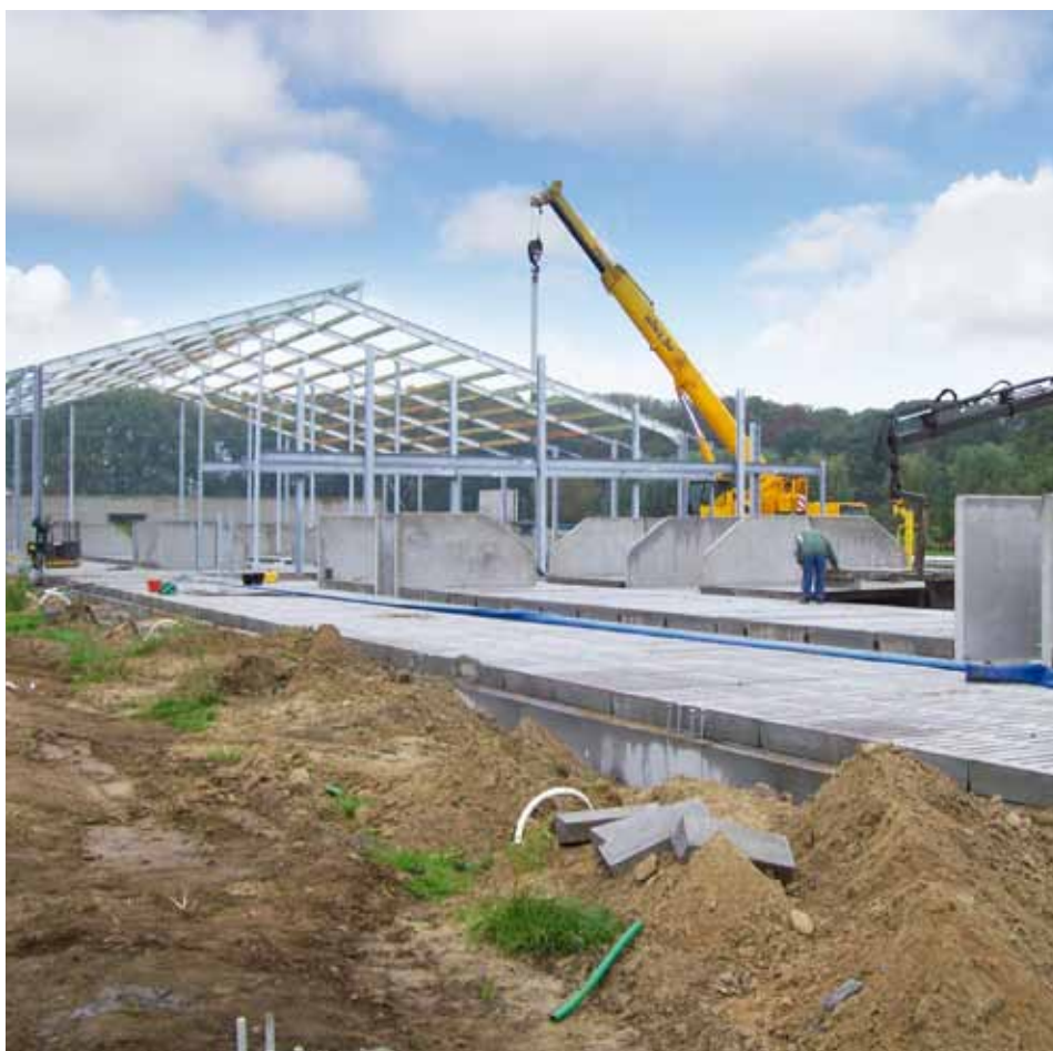
Melkveestal in opbouw, 2012. Met het oog op de stopzetting van de quota hebben vele melkveeboeren geïnvesteerd in een uitbreiding en verbetering van hun patrimonium.
